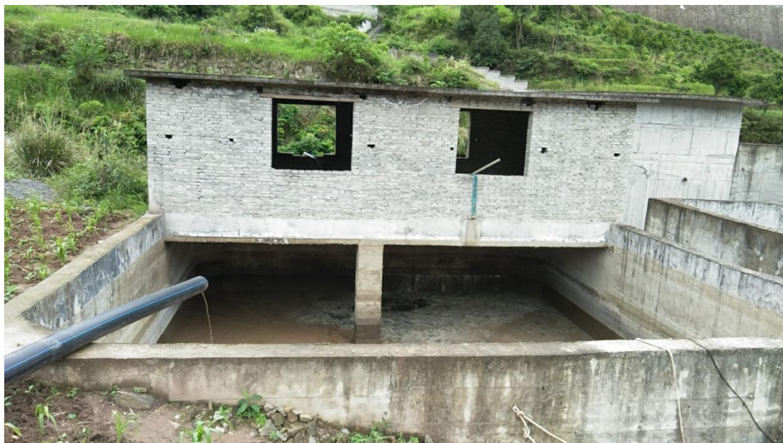
项目污水暂存池
