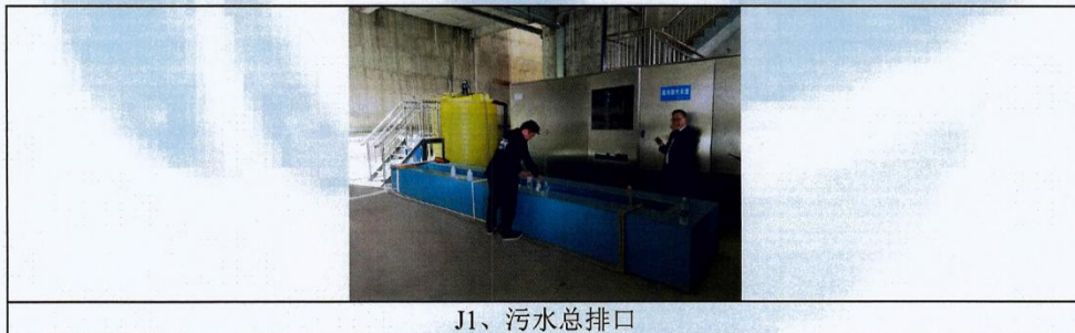
J1、污水总排口
