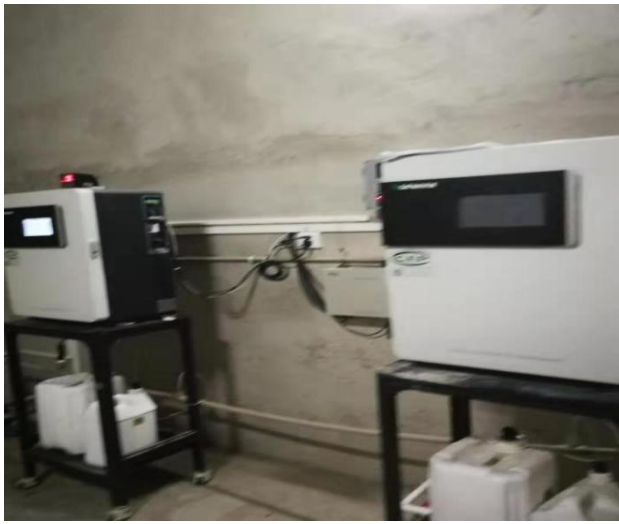
污水处理站在线监测装置
