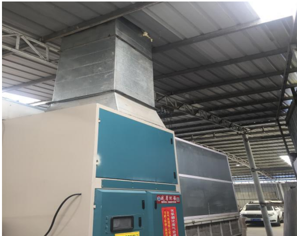
废气处理设施
