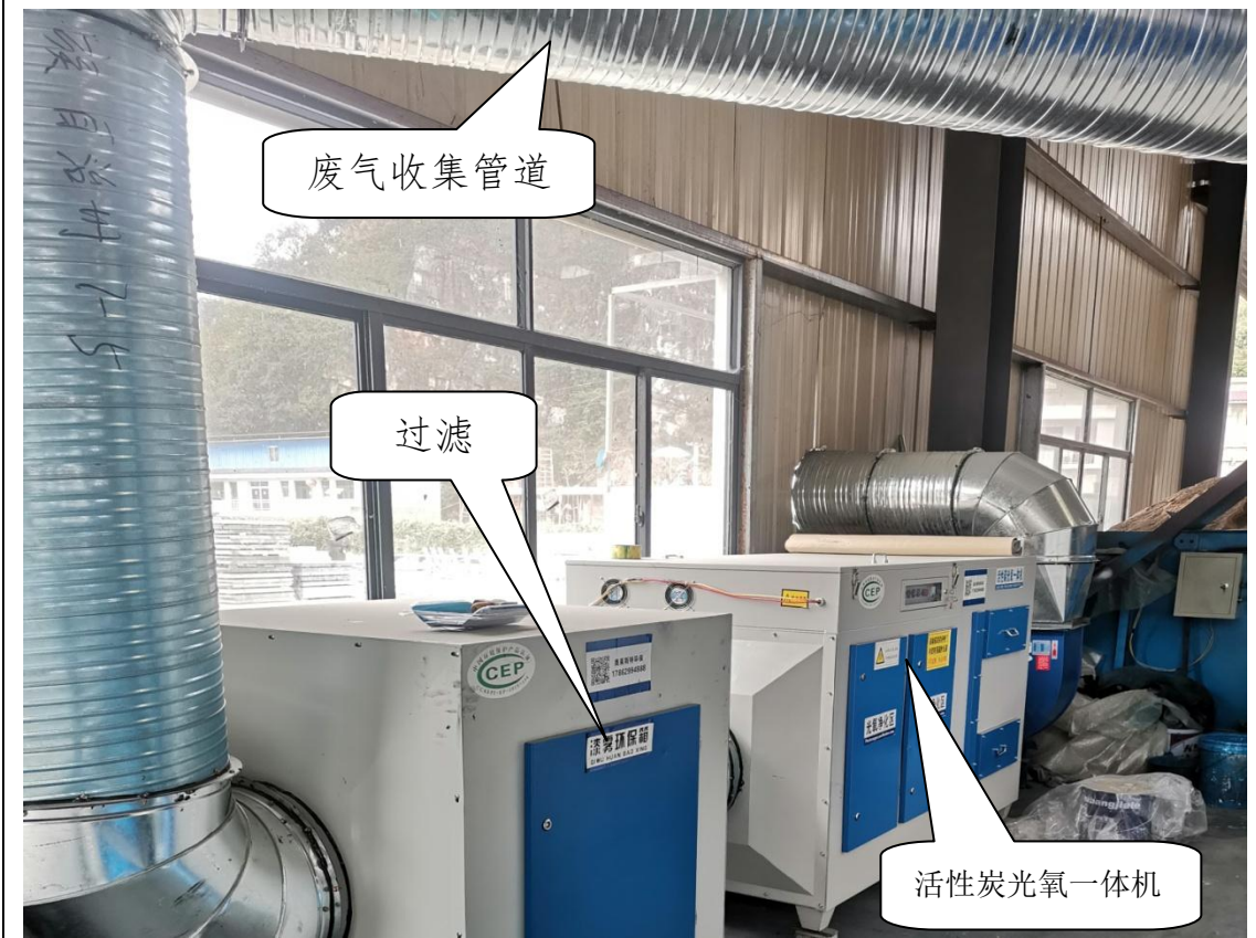
喷漆废气处理设施
