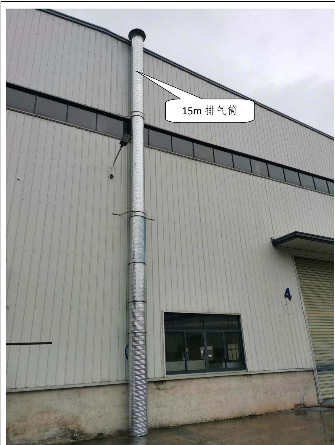
喷漆废气排气筒
