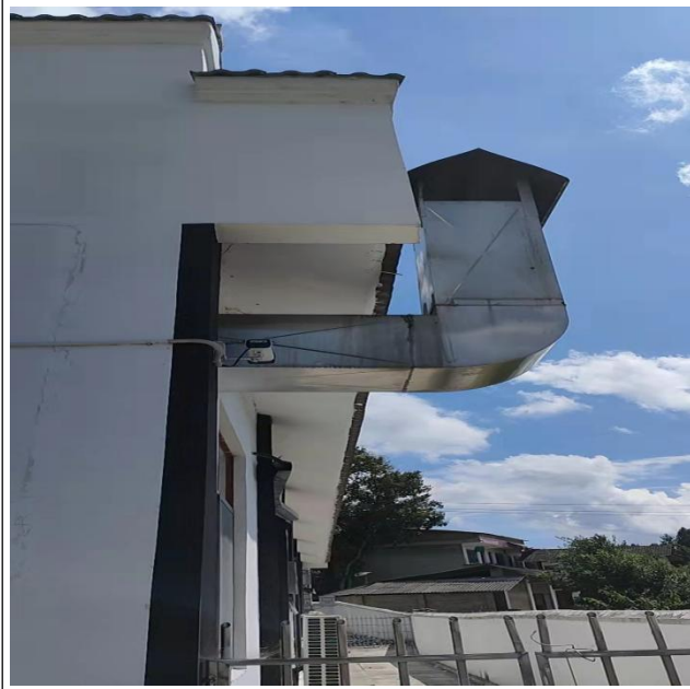
食堂油烟排气筒
